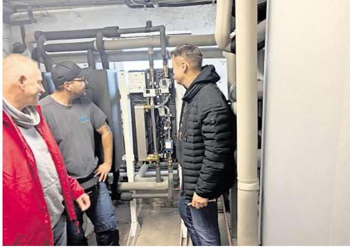
Einweisung in die Wärmepumpe (von links): Detlef Bohlemann (FC Lehrte), Sascha Hayes (Firma Strebost), Björn Rust (FC Lehrte).
