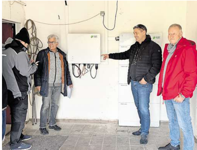
Einweisung in die Photovoltaikanlage mit Batteriespeicher (von links): Daniel Moik (Firma Revi Energie), Michael Claus (FC Lehrte), Björn Rust (FC Lehrte), Detlef Bohlemann (FC Lehrte).
