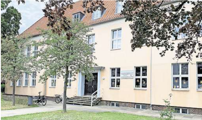
Baufällig: Das ist das aktuelle Gebäude der Ingo-Siegner-Grundschule in Burgdorf.
