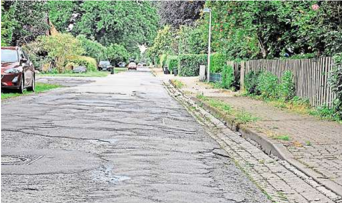
Fördergeld nötig: Die Straße Am Fließgraben in Hänigsen soll eine Grundsanierung bekommen. Foto: HAZ/Archiv
