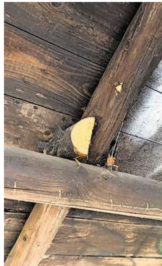
Die Täter haben unter anderem einen Dachbalken herausgetrennt. Foto: Stadt Burgdorf
