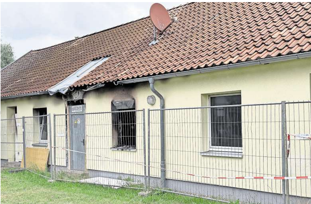
Abgesperrt und unbewohnt: Nach dem verheerenden Feuer in der Obdachlosenunterkunft bereitet die Gemeinde Uetze den Abriss des Gebäudes vor. Foto: Sven Warnecke
