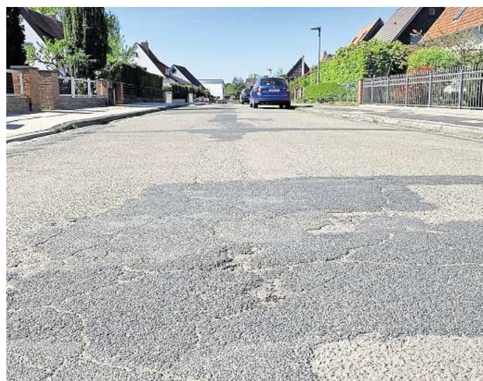
Flickentoppich: Die Stettiner Straße in Burgdorf soll in diesem Jahr eine neue Deckschicht bekommen. Foto: Thea Ball
