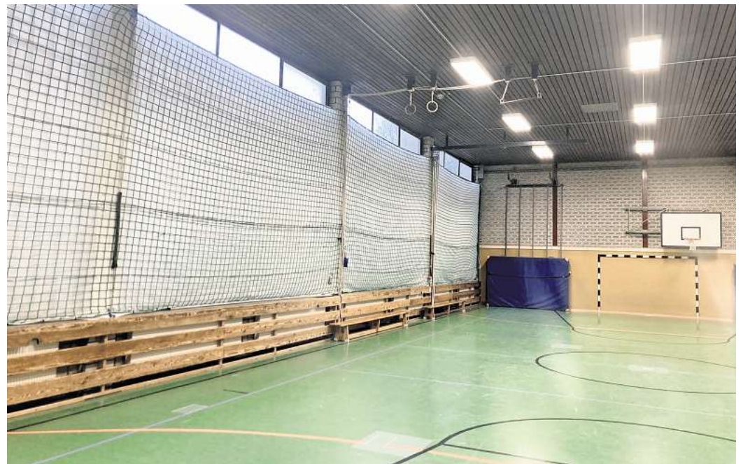
Sanierungsbedürftig: Die Fensterfront in der Sporthalle in Otze ist abgesichert worden.
