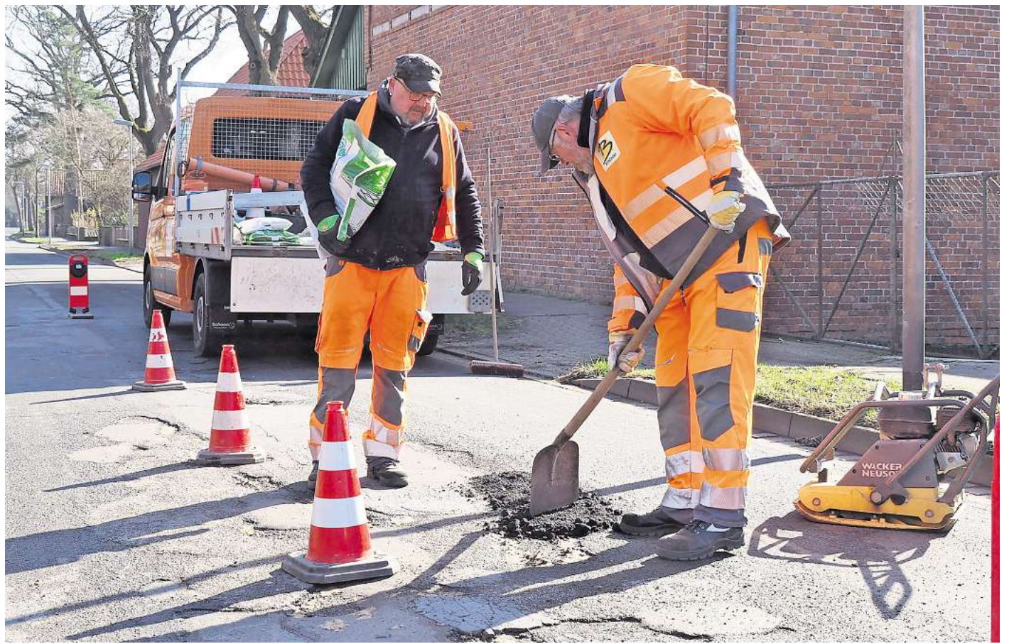
Teamarbeit: Uwe Mohrlüder (links) und Peter Fink bessern gemeinsam ein Schlagloch auf der Worthstraße in Otze aus. Thea Ball
