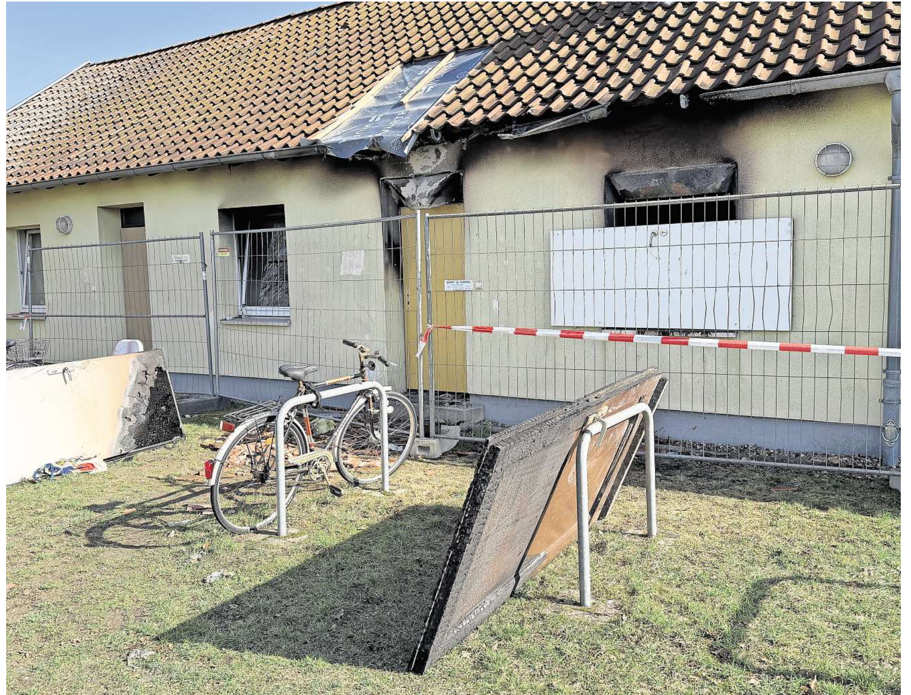
Unbewohnbar: Nach dem Feuer in einer Uetzer Obdachlosenunterkunft muss das Gebäude wohl abgerissen werden.
