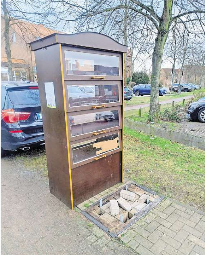
Der Bücherschrank und das Fundament müssen repariert werden. Foto: privat
