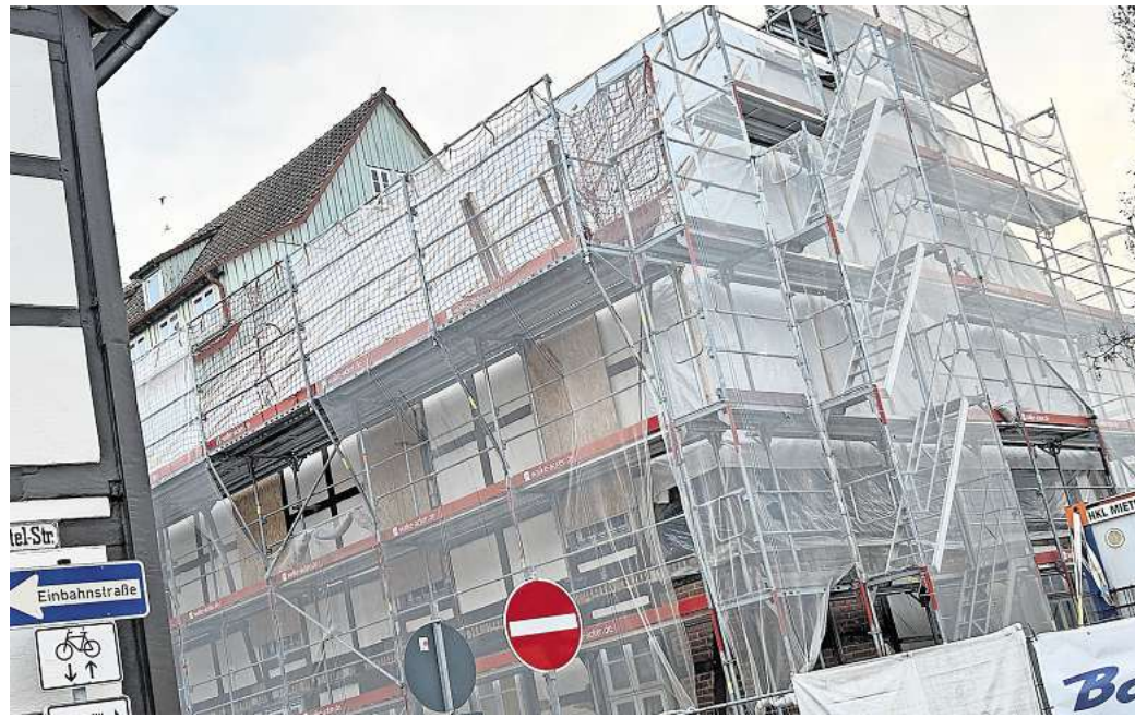
Nach der Sanierung soll eine Photovoltaikanlage auf dem Rathaus I installiert werden. Aus optischen Gründen will die Stadt aber nur einen Teil des Daches mit Modulen versehen. Foto: Andreas Voigt
