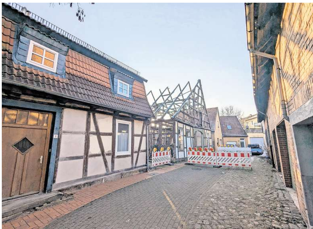
Weil der Giebel sich schon nach vorne neigt, ist die Knickstraße seit nunmehr 17 Monaten gesperrt.
