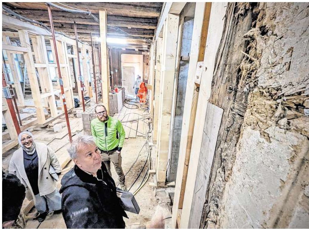
Bausünden aus der Vergangenheit: Im Zuge von Um- und Einbauten sei im Lauf der Jahrzehnte überall im Rathaus I unsachgemäß in die Bausubstanz eingegriffen worden - nicht nur in der Eingangshalle, sagt Architekt Andreas Schmotz (vorne). Foto: Martin Lauber
