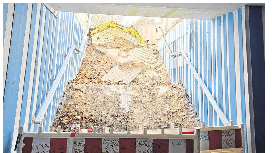
Die Bauarbeiten an der Bahnhofstreppe sind ins Stocken geraten. Foto: privat
