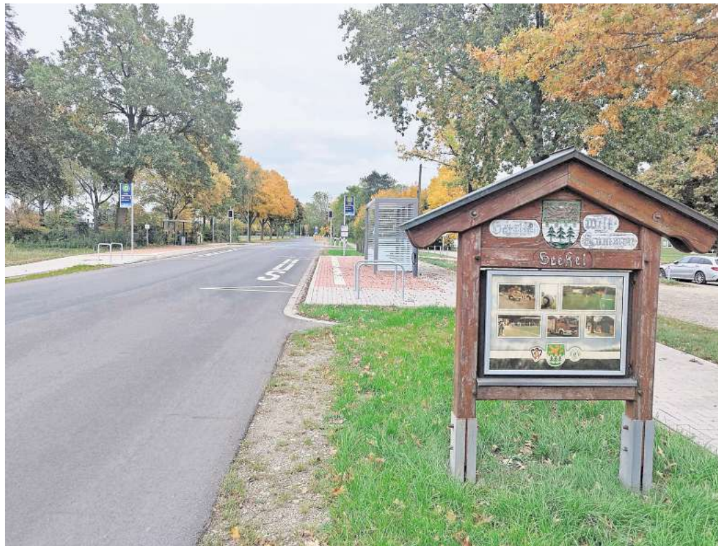
Hier ging es Mitte November 2024 los: Die Dorfstraße in Heeßel ist inzwischen nahezu fertig saniert und wartet mit neuen Bushaltestellen und Gehwegen auf. Foto: Carina Bahl
