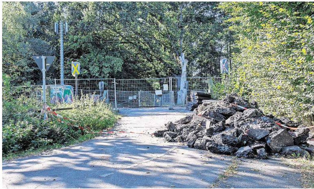
Ausgebaut: Am Bahnübergang in Ahrbeck wurde der Asphalt zwischen den Gleisen durch Schotter ersetzt. Foto: Joachim Lührs
