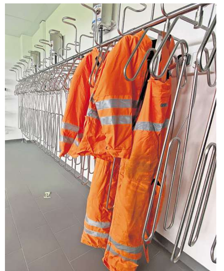
Mitarbeitende können ihre nasse Kleidung in einem Trockenraum auf Bügel hängen, die warme Luft in die Hosen und Jacken pusten.
