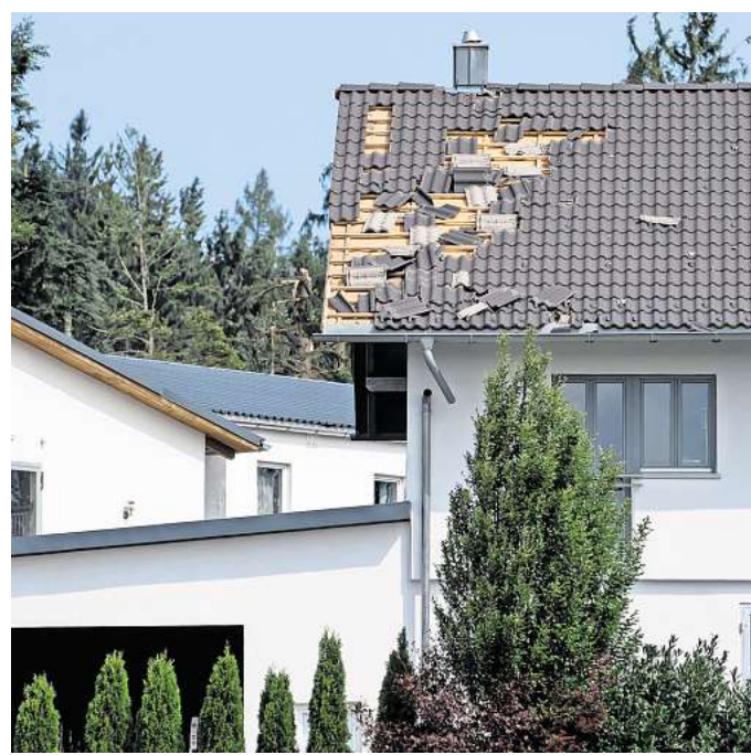
Hat ein Sturm das Dach des Eigenheims beschädigt, kommt die Wohngebäudeversicherung für den Schaden auf. Foto: Sven Hoppe/dpa/dpa-mag
