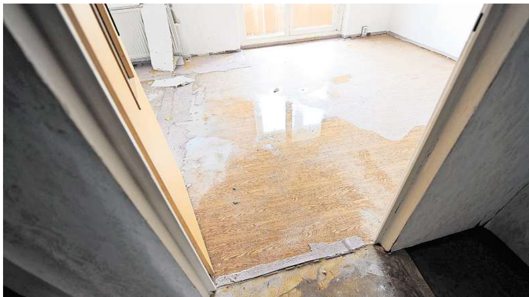
Wasserschaden in der Wohnung? Mieterinnen und Mieter sollten sich jetzt umgehend an ihren Vermieter wenden.
