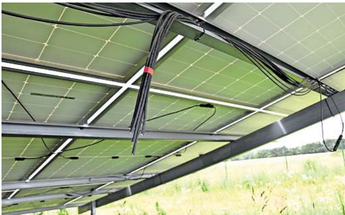
Spuren des Diebstahls: gekappte Kabel unter den Solarpaneelen. Foto: Frank Walter
