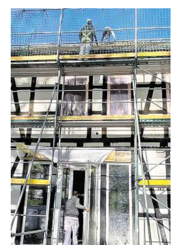
Eingerüstet: Arbeiter erneuern die Fassade vom „Voltmers Hof“ und säubern das Dach. Foto: Katerina Jarolim-Vormeier
