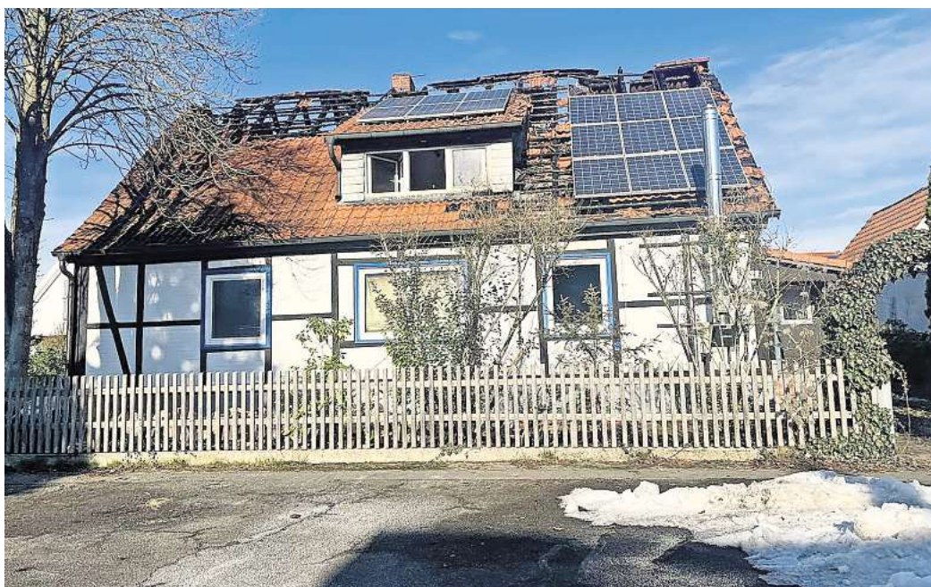
Am Sonntag nach dem Feuer: Das Einfamilienhaus gilt als unbewohnbar, es fehlen die Fensterscheiben, im Inneren ist eine Decke eingestürzt und ein großer Teil des Dachs fiel den Flammen und Löscharbeiten zum Opfer.
