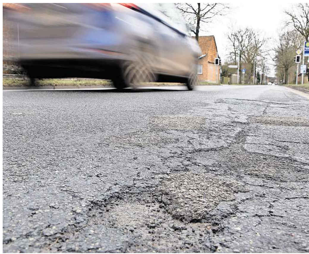
Flickstellen und Schlaglöcher: Die Fahrbahndecke ist in keinem guten Zustand. Foto: Frank Walter
