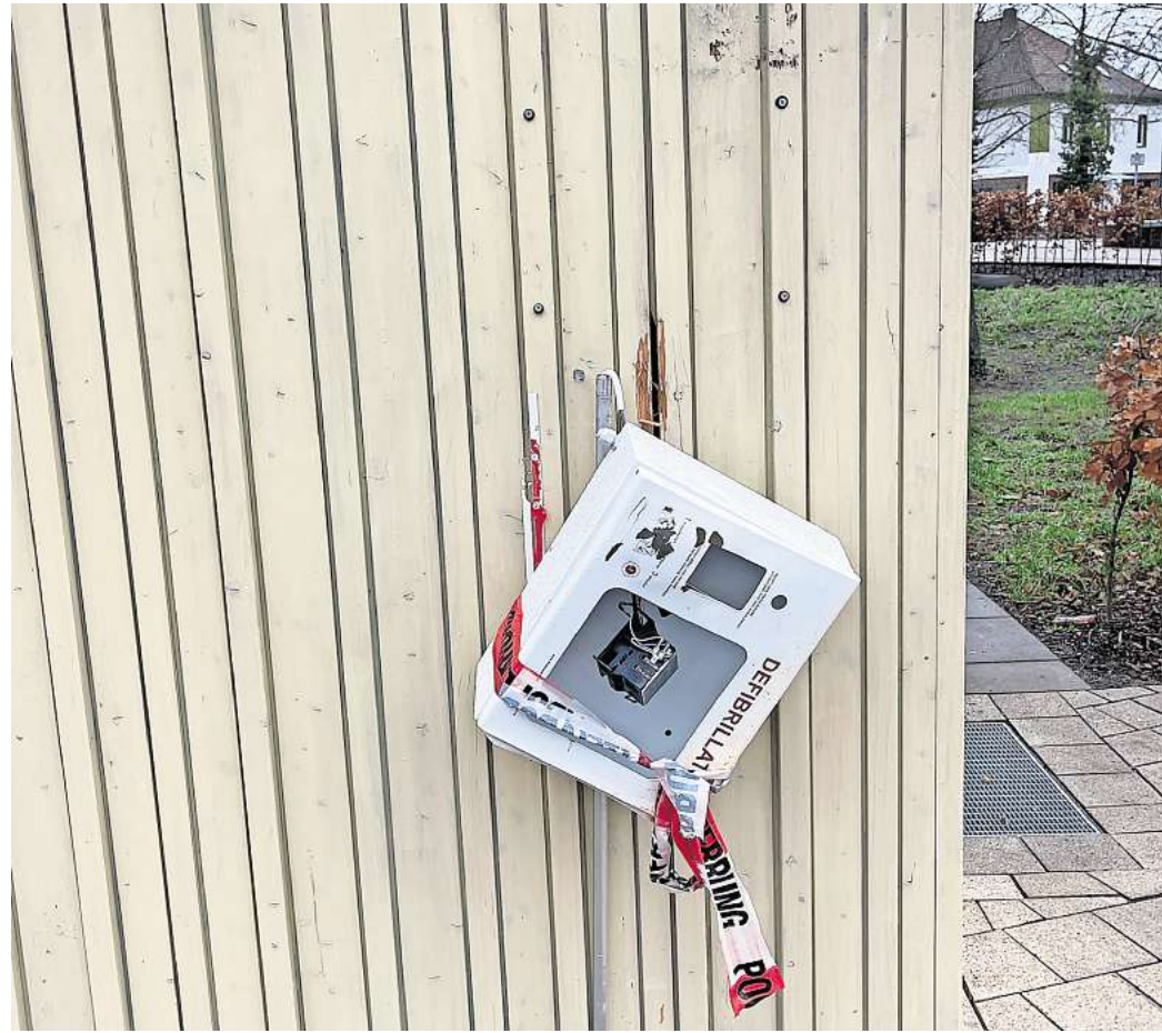
Durch eine Detonation zerstört: die Halterung des Defibrillators.
