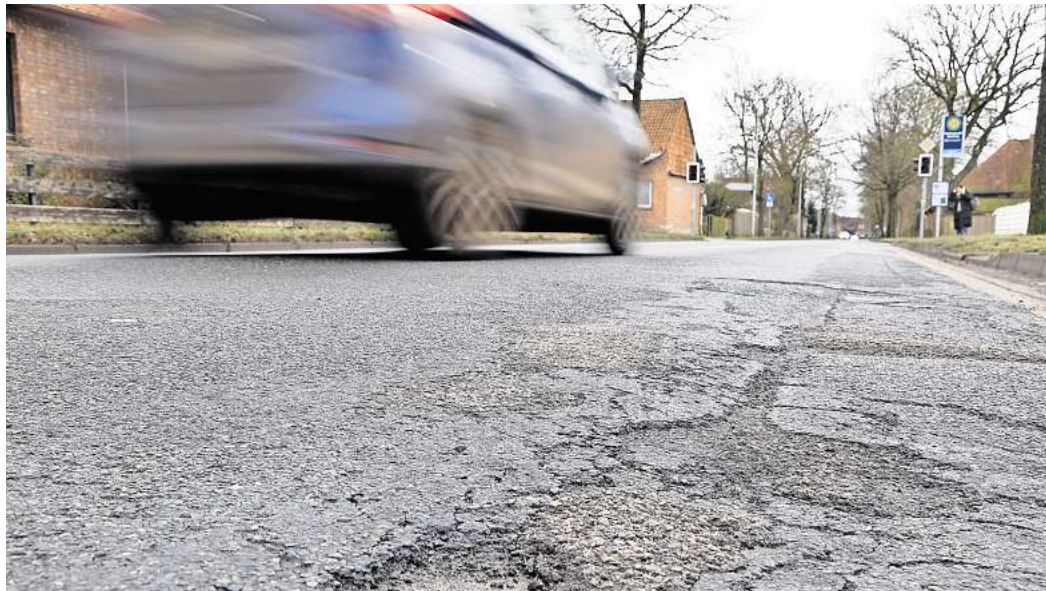
Flickstellen und Schlaglöcher: Die Fahrbahndecke in der Ortsdurchfahrt Kleinburgwedel ist in keinem guten Zustand. Foto: Frank Walter
