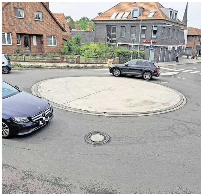
Muss repariert werden: der Vatter-Kreisel Hannoversche Straße/Fuhrberger Straße in Grobburgwedel. Foto: Frank Walter
