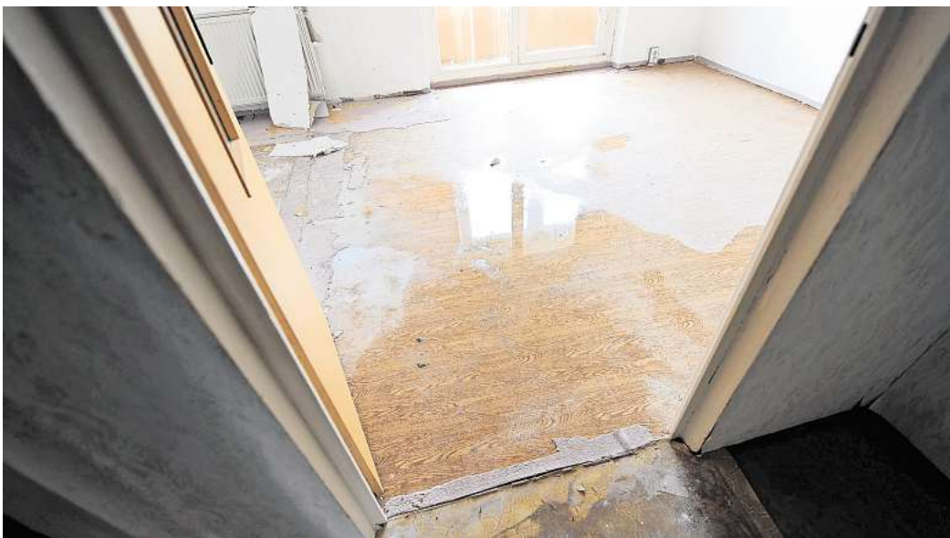
Wasserschaden in der Wohnung? Mieterinnen und Mieter sollten sich jetzt umgehend an ihren Vermieter wenden.
