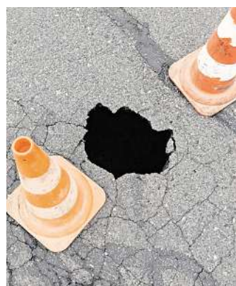
Loch in der Straße Am Gehrkamp am Freitag, 13. März. Foto: Reiner Pawlak
