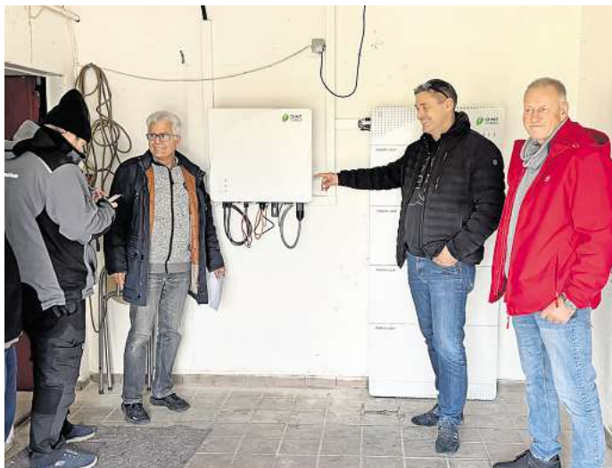
Einweisung in die Photovoltaikanlage mit Batteriespeicher (von links): Daniel Moik (Firma Revi Energie), Michael Claus (FC Lehrte), Björn Rust (FC Lehrte), Detlef Bohlemann (FC Lehrte).
