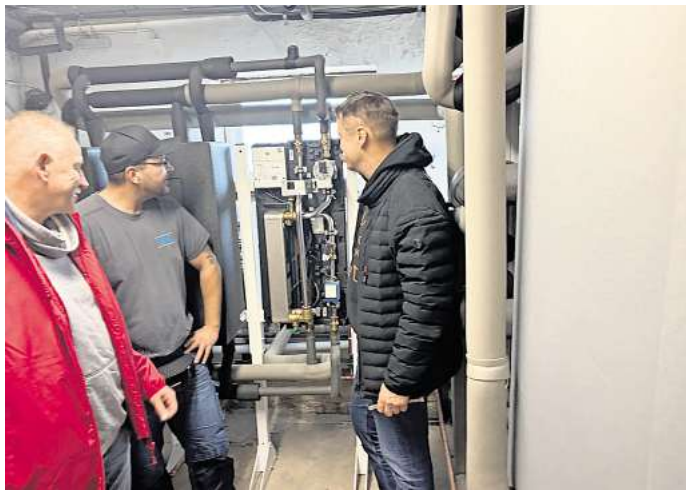
Einweisung in die Wärmepumpe (von links): Detlef Bohlemann (FC Lehrte), Sascha Hayes (Firma Strebost), Björn Rust (FC Lehrte).
