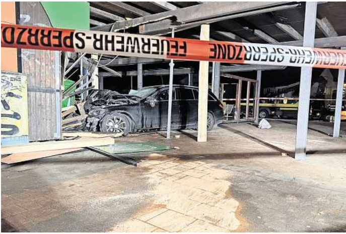
Crash an der Haltestelle: Die Fahrt des Mercedes endet am Toilettenhäuschen, die Wucht des Aufpralls bringt das Dach fast zum Einsturz. Foto: Stadtfeuerwehr Sehnde
