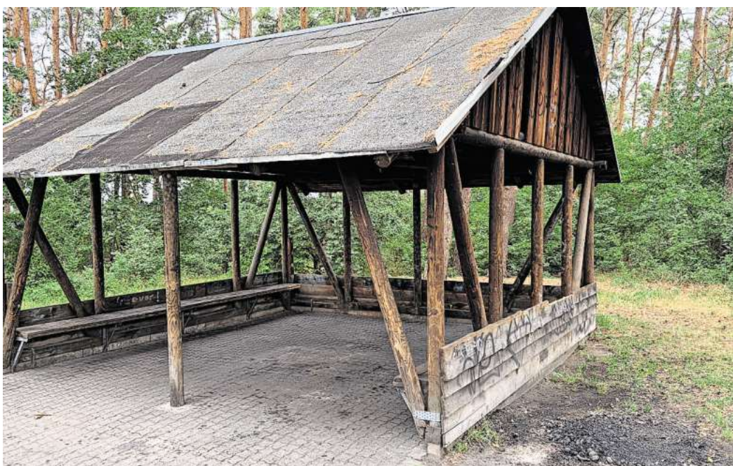
Die Grillhütte ist massiv beschädigt. Daneben finden sich Reste eines offenen Lagerfeuers.
