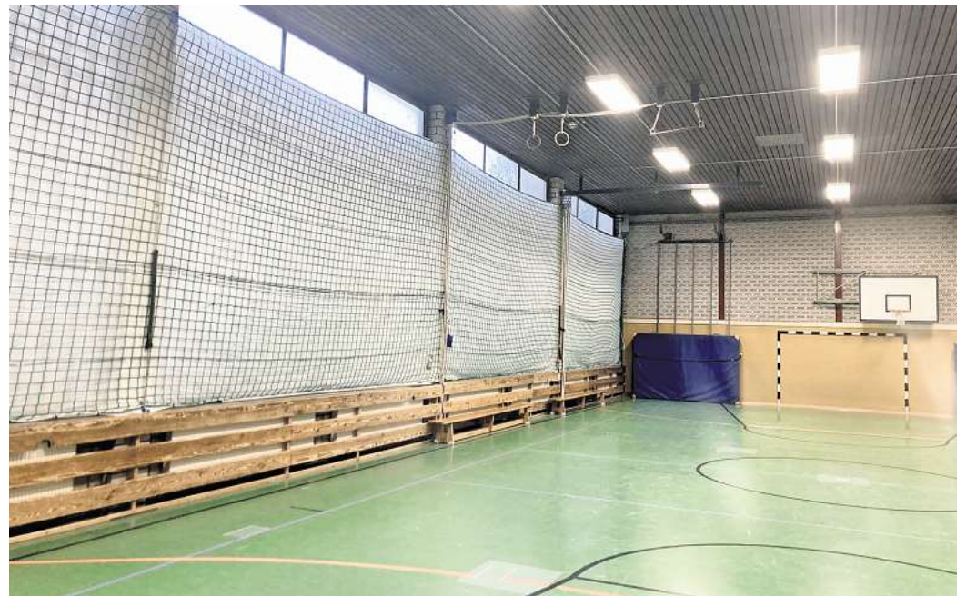
Sanierungsbedürftig: Die Fensterfront in der Sporthalle in Otze ist abgesichert worden.
