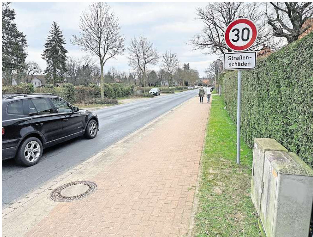
Angesichts der immensen Schäden auf Straßen im Uetzer Gemeindegebiet - hier in Hänigsen - hat die Verwaltung vielfach Tempolimits bis zur Sanierung angeordnet. Foto: Sven Warnecke
