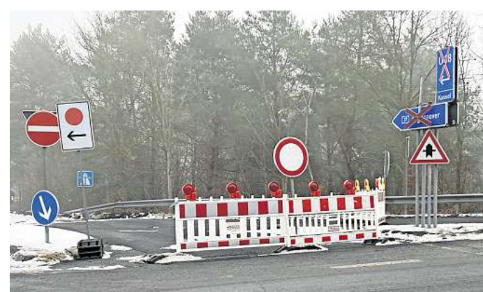
Die A37 im Bereich Burgdorf wird noch bis August 2026 saniert. Deshalb ist die Auf- und Abfahrt Burgdorf-Kolhorn noch gesperrt.
