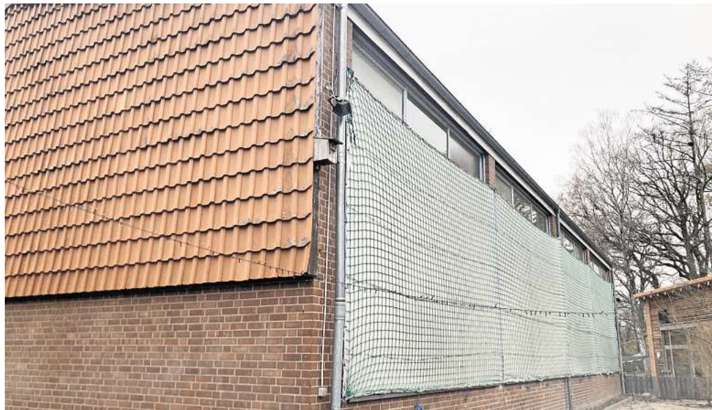
Außensicht: Folien verdecken die maroden Glasbausteine.
