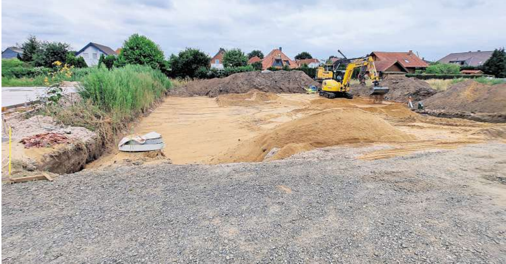
Schwieriger Untergrund: Erst musste viel Erde bewegt werden, um später auf dem Grundstück ein Haus errichten zu können.
