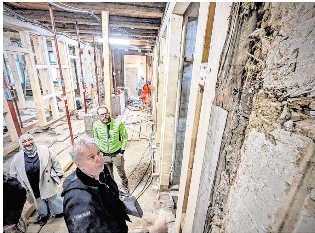
Bausünden aus der Vergangenheit: Im Zuge von Um- und Einbauten sei im Lauf der Jahrzehnte überall im Rathaus I unsachgemäß in die Bausubstanz eingegriffen worden - nicht nur in der Eingangshalle, sagt Architekt Andreas Schmotz (vorne). Foto: Martin Lauber
