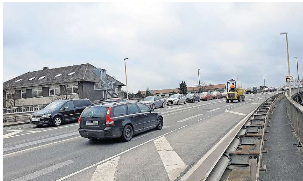
Die Burgdorfer Hochbrücke von 1974 hat Korrosionsschäden. Sie ist zwar nicht akut einsturzgefährdet, muss aber neu gebaut werden. Foto: Sandra Köhler
