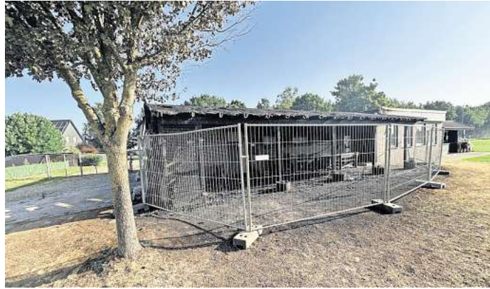
Abgesperrt: Wegen fehlender Umkleidekabinen und Duschen muss der Spielbetrieb in Obershagen aktuell ruhen.
