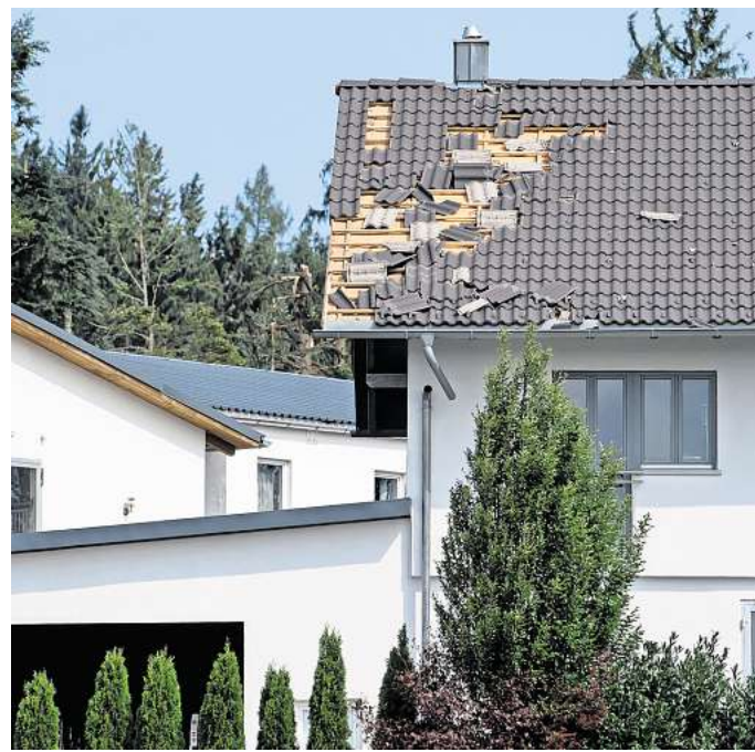
Hat ein Sturm das Dach des Eigenheims beschädigt, kommt die Wohngebäudeversicherung für den Schaden auf. Foto: Sven Hoppe/dpa/dpa-mag
