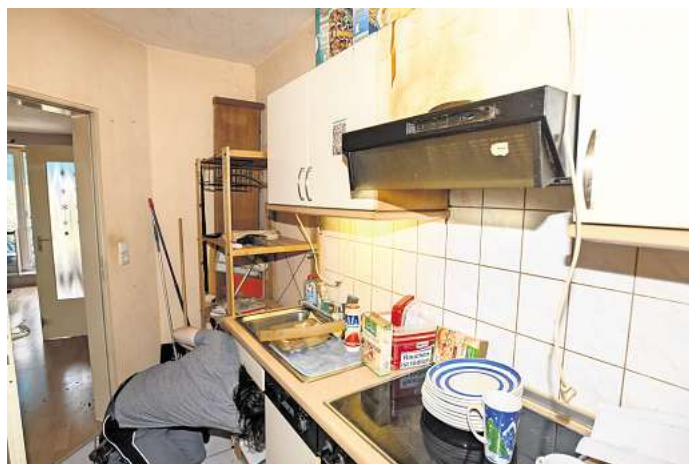
Auch in der Küche hat die Mieterin Chaos hinterlassen - mit vollen Mülleimern, Feuchtigkeit und angekokelten Schranktüren. Foto: Nancy Heusel
