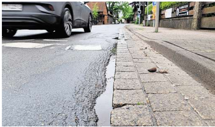
Ziemlich marode: Schäden auf der Straße Am Ortfelde in Isernhagen N.B. Foto: Frank Walter
