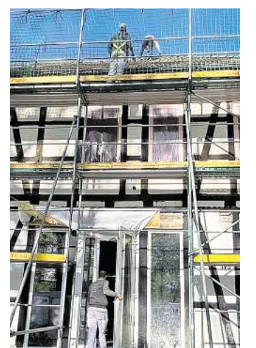
Eingerüstet: Arbeiter erneuern die Fassade vom „Voltmers Hof“ und säubern das Dach. Foto: Katerina Jarolim-Vormeier
