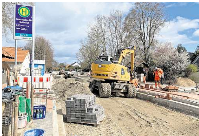
Letzte Arbeiten vor den Osterfeiertagen: Arbeiter pflastern den Gehweg an der K113 in F.B. Foto: Katerina Jarolim-Vormeier
