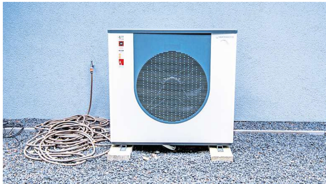
Moderne Wärmepumpen sind leiser als früher: Mit unter 50 Dezibel arbeiten sie so leise wie ein Geschirrspüler.
