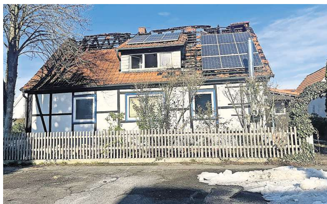
Am Sonntag nach dem Feuer: Das Einfamilienhaus gilt als unbewohnbar, es fehlen die Fensterscheiben, im Inneren ist eine Decke eingestürzt und ein großer Teil des Dachs fiel den Flammen und Löscharbeiten zum Opfer.
