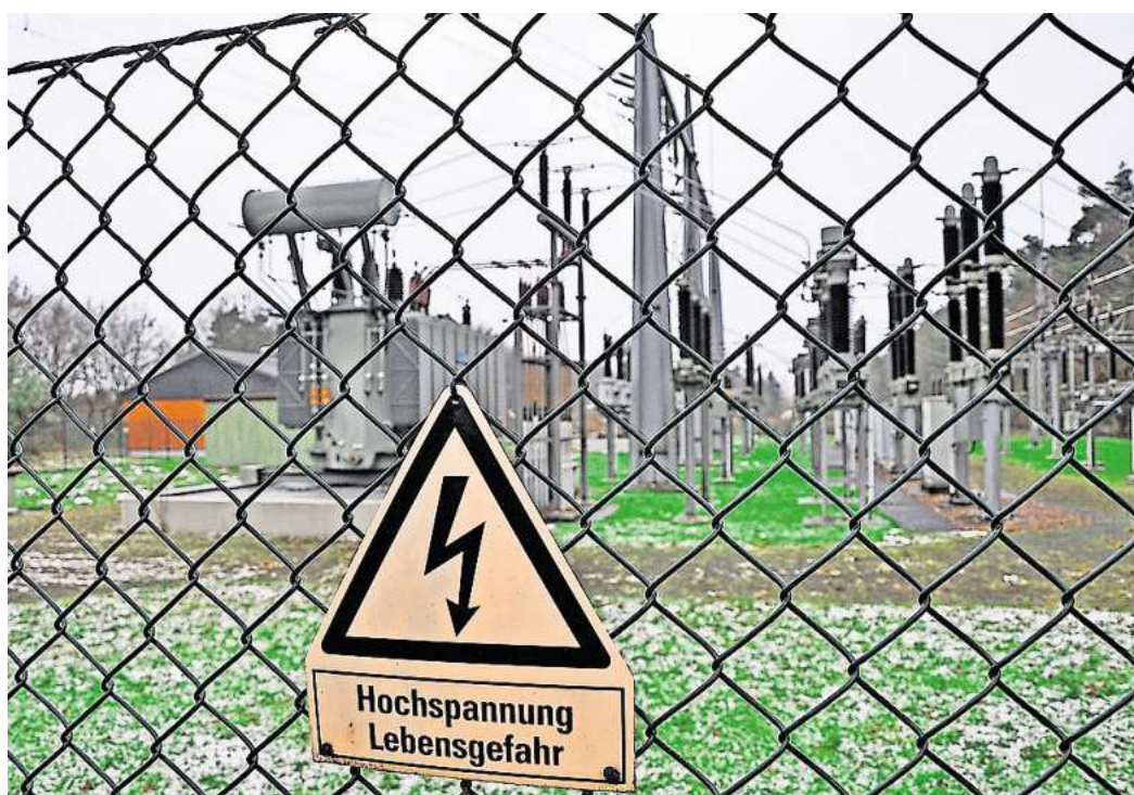
Von hier gehen die neuen Stromtrassen los: Das Umspannwerk Burgwedel nahe Thönse. Foto: Frank Walter
