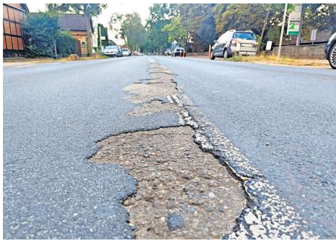
K112 in Altwarmbüchen: Mit einer Sanierung der Ortsdurchfahrt (Hannoversche Straße) rechnet die Region nicht vor 2027. Foto: Carina Bahl
