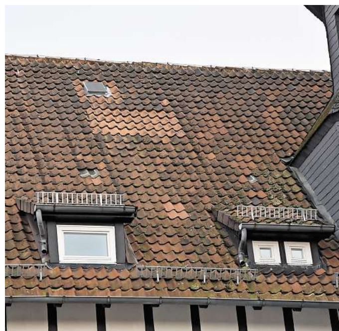
Bislang wurde nur ausgebessert: Helle Dachpfannen zeugen von Reparaturarbeiten.
