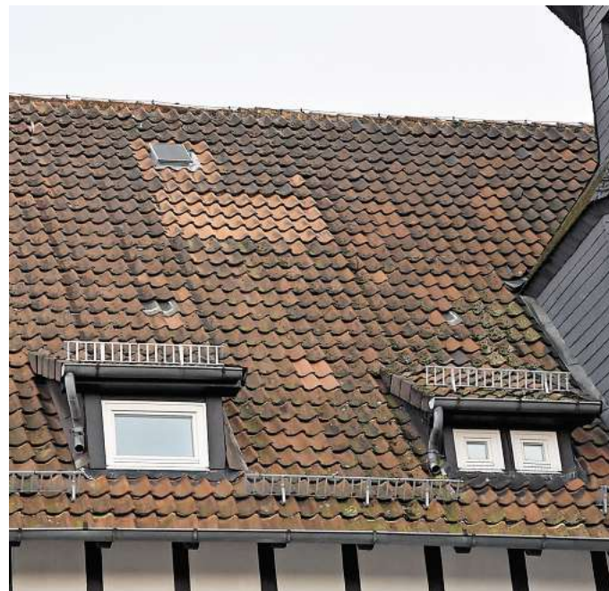
Bislang wurde nur ausgebessert: Helle Dachpfannen zeugen von Reparaturarbeiten.
